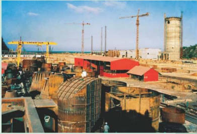
Lắp đặt thiết bị các nhà máy sản xuất vật liệu xây dựng . Installation of equipments for construction-material-production plants.
