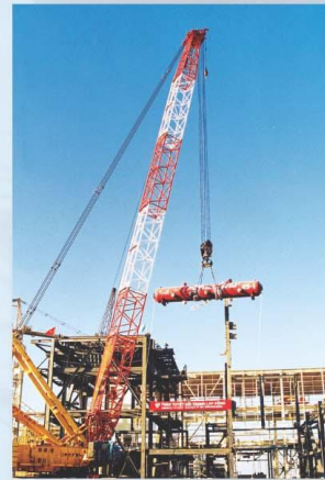
Lắp đặt bao hơi nặng 70 tấn - Nhiệt điện Phú Mỹ 1. Lifting up a 154-ton Steam Drum - Phu My 1 Thermal Power Plant.
