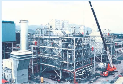
Lắp đặt thiết bị, nhà máy nhiệt điện Bà Rịa. Installation of equipments Ba Rịa Thermal Power Plant.
