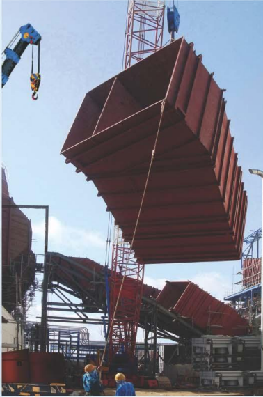
Lắp đặt Air duct, nhà máy nhiệt điện Ô Môn. Installation of Air ducts - O Mon Thermal Power Plant.
