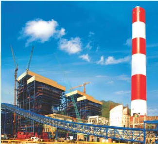
Lắp thiết bị các nhà máy nhiệt điện. Installation of equipments for thermal power plants.
