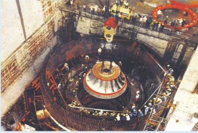
Lắp đặt bánh xe công tác nặng 74 tấn tổ máy số 01 nhà máy thủy điện Trĩ An. Installation of 74-ton screw propeller for Trĩ An Hydro Power Plant.
