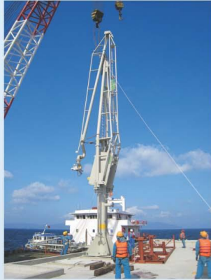
Lắp đặt trạm bơm xăng dầu, kho cảng biển Vân Phong Khánh Hòa. Installation of petroleum pumping station Van Phong External Petroleum Terminal - Khanh Hoa.
