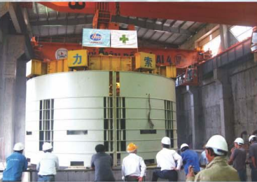
Lắp đặt Stator máy phát 270 tấn nhà máy thủy điện Đồng Nai 4. Installation of 270 -ton Stator of Generator for Dong Nai 4 Hydro Power Plant.
