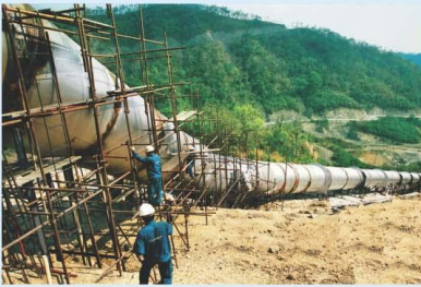
Lắp đặt đường ống áp lực nhà máy thủy điện Đại Ninh. Installation of penstock for Đại Ninh Hydro Power Plant.
