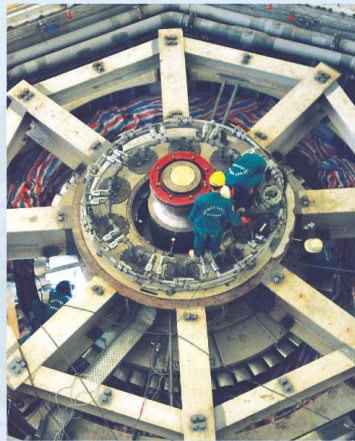
Lắp đặt turbine nhà máy thủy điện Đồng Nai 3. Installation of 240 - ton Rotor of Generator for Dong Nai 3 Hydro Power Plant.
