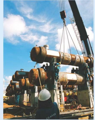
Lắp đặt bộ trao đổi nhiệt nhà máy lọc dầu Dung Quất . Installation of Heat Exchanger for Dung Quat Oil Refinery Plant.
