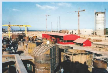
Chế tạo, lắp đặt thiết bị và kết cấu thép cho nhà máy xi măng Sao Mai – Kiên Giang. Fabrication and installation of equipments and steel structures for Sao Mai Cement Plant – Kien Giang Province.
